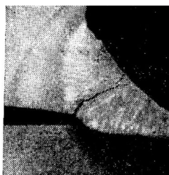
Рисунок 10.11 – Трещина в одностороннем шве
